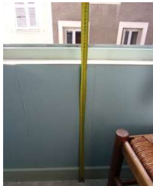
Hauteur d'allège de fenêtre insuffisante / absence de garde-corps
